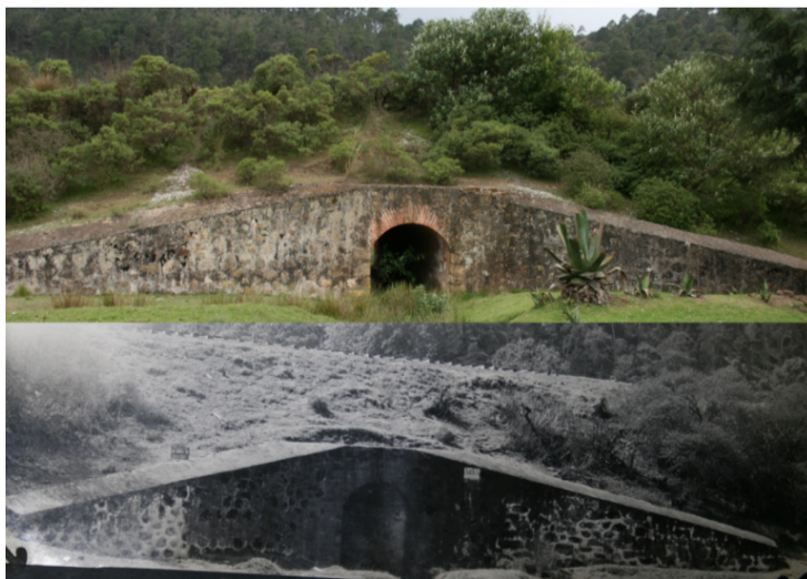
18. Alcantarilla H-149-D o Alcantarilla 089, entre las estaciones de Xocopa y Cima de Togo.
