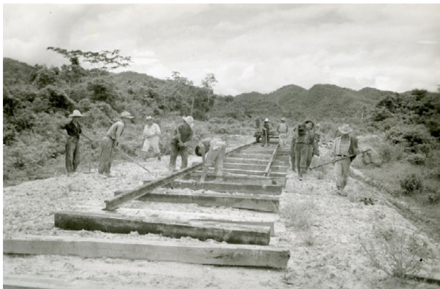
Tenosique. Tendido de vía en el kilómetro 335/500, entre Río Usumacinta y Río Polevá 1
